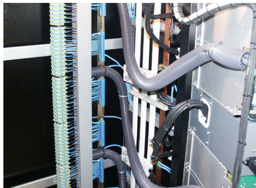
Obr. 119: Pohled zezadu na propojovací pole stmívačové rozvaděčové skřín (Transtechnik)
