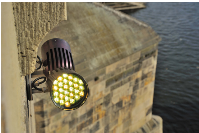
Obr. 76: Miniaturní svítidlo LED na vnějším plášti Karlova mostu
