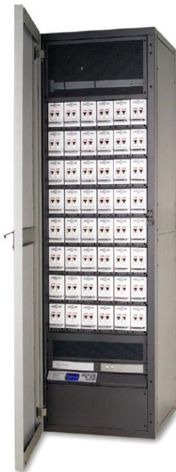
Obr. 118: Stabilní rozvaděčová skříň se 96 ks stmívačů à 2,5 KW (Transtechnik)
